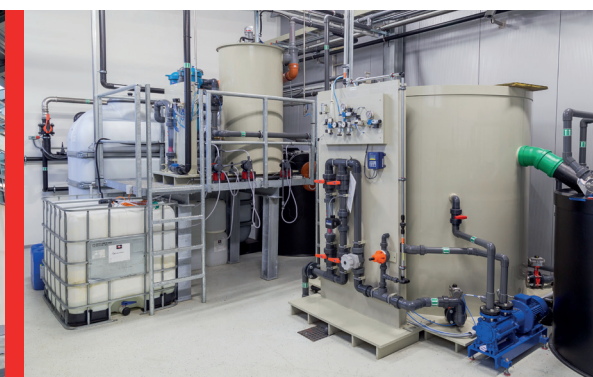
◀ с лева на право: Установка мойки трамваев Цепной транспортёр для перемещения питающих проводов
