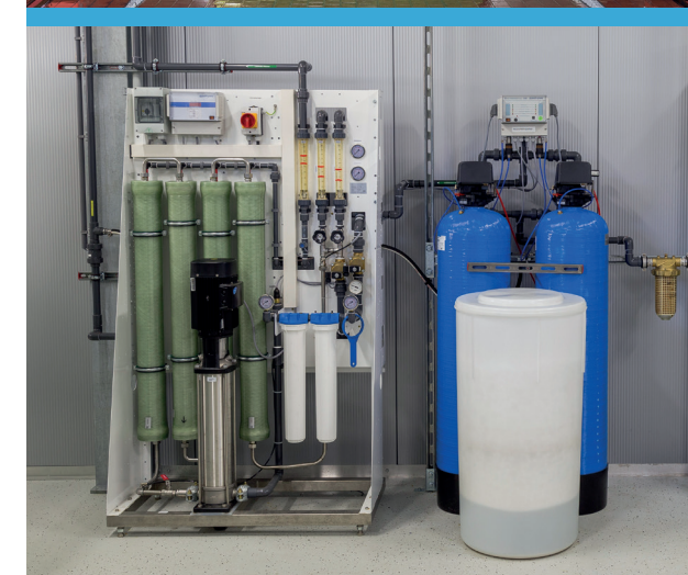
▲ Установка мойки грузовых автомобилей (вверху) Установка обратного осмоса (внизу)
